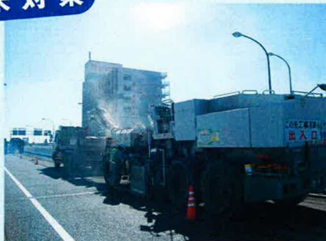
■粉じん未対策での施工
